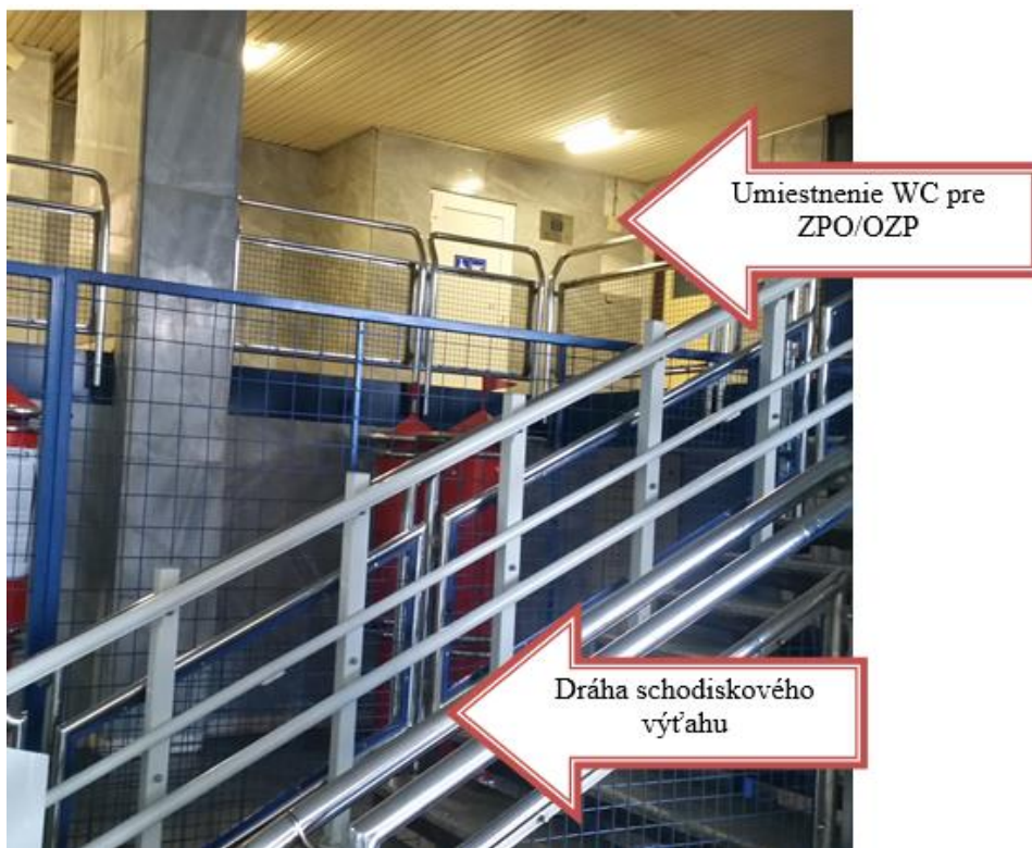
Obrázok 21 Zabezpečenie schodiskového výťahu
